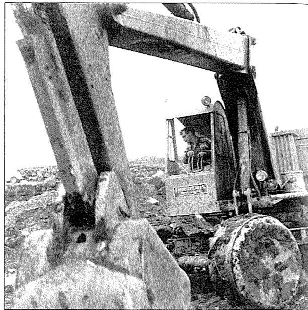
Bildet er frå nydyrking hos Anfinn Line i Hå kommune. Arbeidet var sett ut, det er Rassin Haugseng frå Nærbø som eig og styrer gravemaskina. To "Brøytar" var i gang med å fjerne steinen og legge han i grøfter eller hol, 4-5 m. djupe. Ei veke skulle det ta å dyrke opp teigen på 18 dekar. Kjelde: Med hydrauliske krefter i nybrotet, Bondevennen 1966 s. 920-922. *Foto: Bondevennen.
